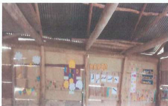
Foto 3: TECHO EN MALAS CONDICIONES.
