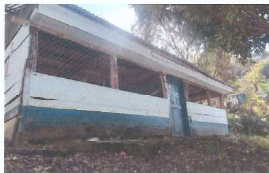
Foto 2: SE PUEDE VERIFICAR EN ESTA IMAGEN, EL MAL ESTADO DE LA MADERA QUE COMPONE LAS INSTALACIONES DEL NIVEL PREPRIMARIO.
