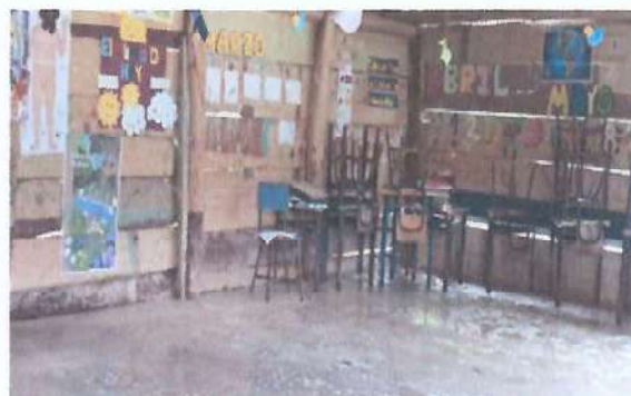
Foto 4: EN INVIERNO, EL AULA SE LLENA DE MOHO POR MUCHA HUMEDAD.
